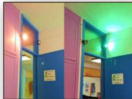
Εικόνα 202. Κουδούνι διαλείμματος (λευκό φως) και φως σε θέση κουδουνιού πόρτας (πράσινο φως) (Ειδικό Δημοτικό σχολείο Κωφών & Βαρηκόνων Πανοράματος Θεσσαλονίκης)
