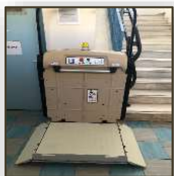
Εικόνα 98. Αναβατόριο (Ειδικό Δημοτικό σχολείο Ερμούπολης)
