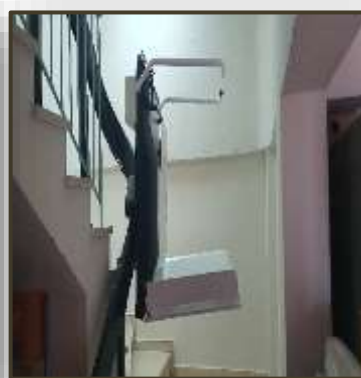
Εικόνα 97. Αναβατόριο κλίμακας με πλατφόρμα (Ε.Ε.Ε.ΕΚ. Άρτας)
