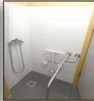
Εικόνα 177. Ντουζιέρα (Ειδικό Νηπιαγωγείο Δράμας)
