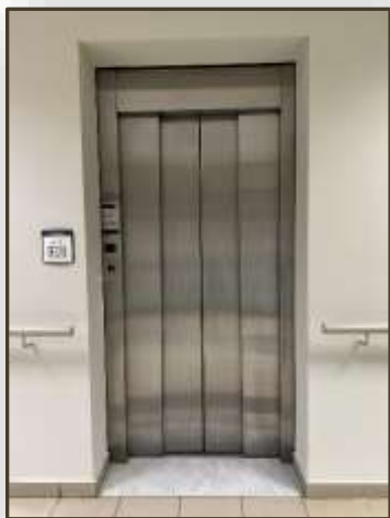
Εικόνα 78. Ανεγκυστήρας (Ε.Ε.Ε.ΕΚ. Ηρακλείου Αττικής)
