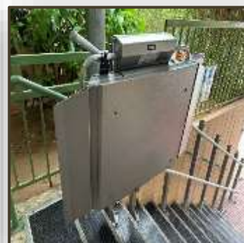
Εικόνα 100. Αναβατόριο κλίμακας με πλατφόρμα (5 ο Δημοτικό Σχολείο Νέας Σμύρνης)
