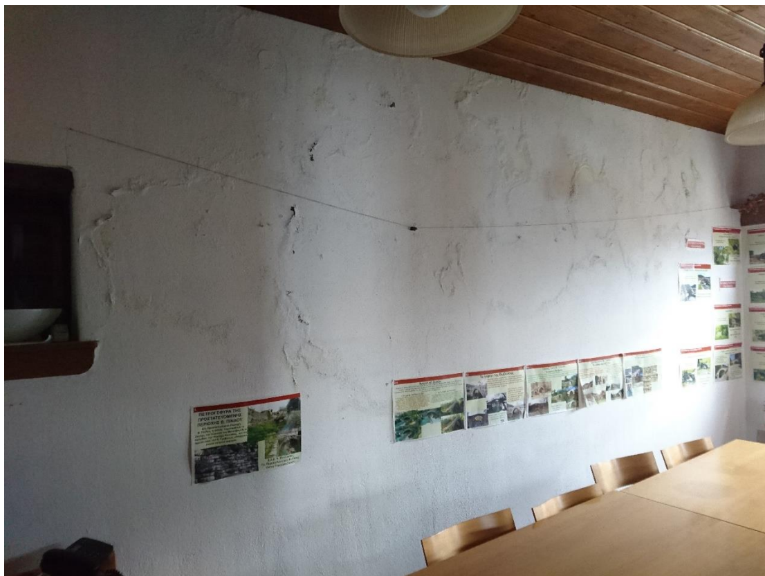
ΚΠΕ Μακρινίτσας. Αποσάθρωση και αποφλοίωση του εσωτερικού επιχρίσματος στο πάνω μέρος της βορεινής φέρουσας λιθοδομής του 2 ου Ορόφου.
