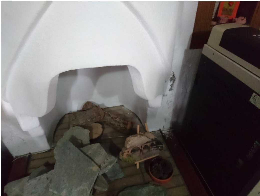
Αποσάθρωση και αποφλοίωση του εσωτερικού επιχρίσματος και μικρή αποκόλληση και πτώση μέρους αυτού, στο κάτω μέρος της βορεινής φέρουσας λιθοδομής του 1 ου Ορόφου, παραπλεύρως του τζακιού.
