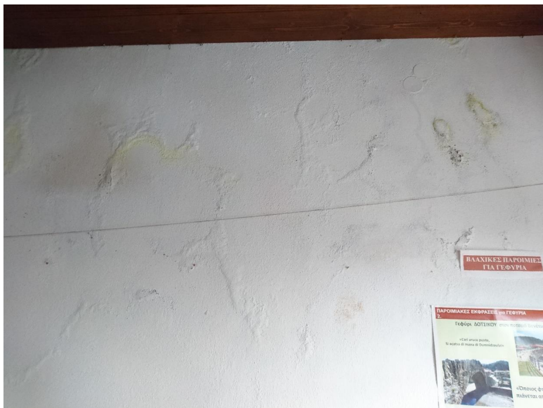
Αποσάθρωση και αποφλοίωση του εσωτερικού επιχρίσματος στο πάνω μέρος της βορεινής φέρουσας λιθοδομής του 2 ου Ορόφου.
