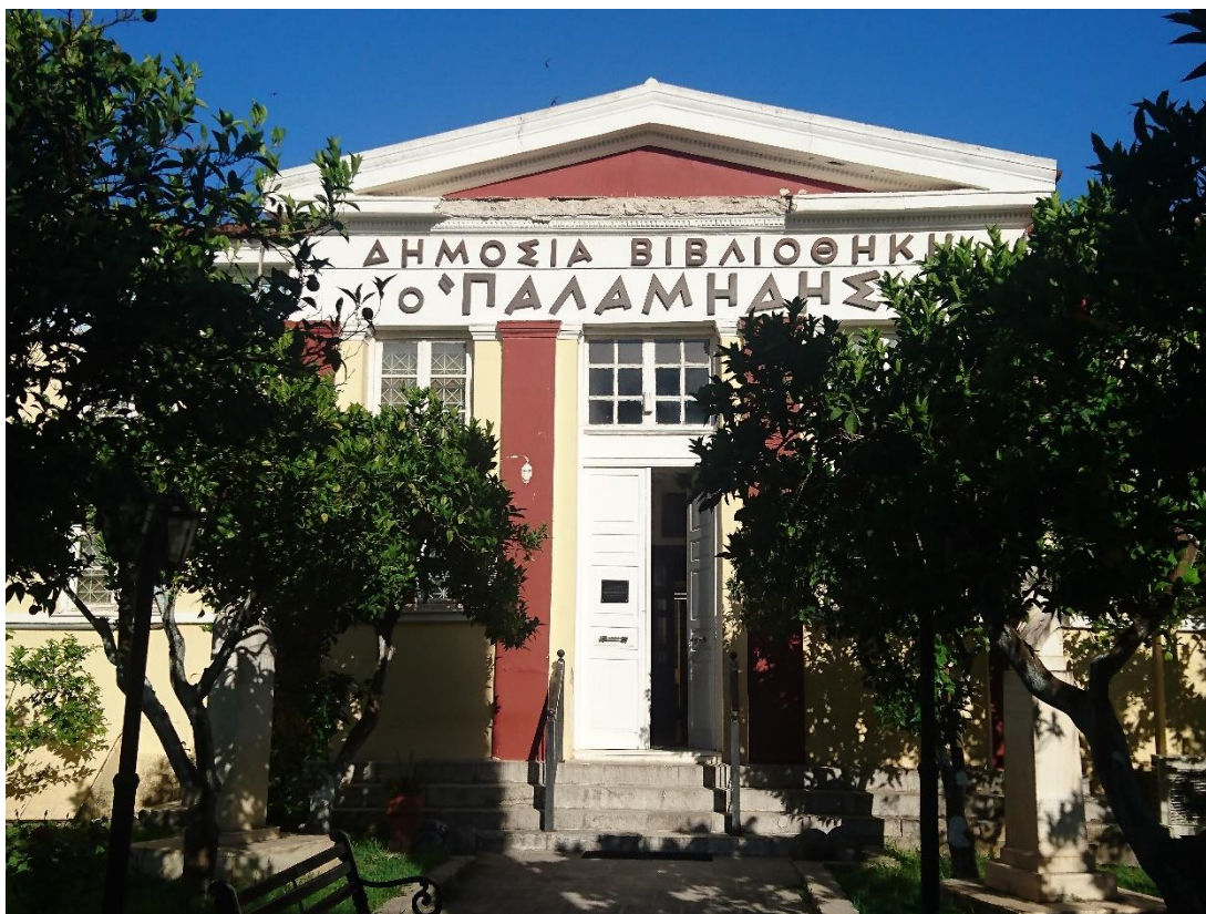
Πτώση τμήματος του αετώματος της κεντρικής εισόδου της Δημόσιας Κεντρικής Βιβλιοθήκης Ναυπλίου επί της οδού Κωλέττη.
